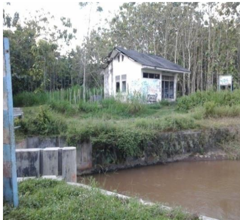
Kantor Pengairan yang rusak Sumber: Doc.Sabrina Paramita
